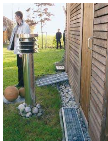
Le nez d'une maison passive : prise d'air à l'extérieur
