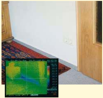
La thermographie révèle les courants d'air indésirables à proximité des portes de cave et des fenêtres.
