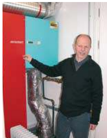
Le système de ventilation de confort, le chauffage et l'eau chaude peuvent aujourd'hui prendre la forme d'un appareil intégré et compact, qui prend à peine plus de place qu'un réfrigérateur. Ingénieur Günter Lang.
