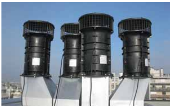
Conduits de ventilation naturelle assistée
