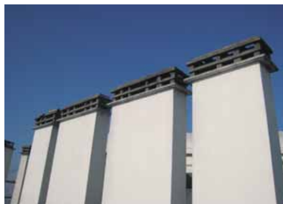
Conduits de ventilation naturelle
