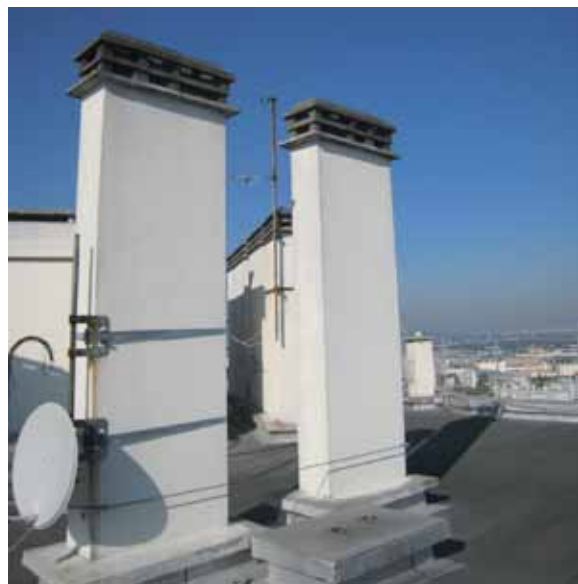
Conduits de ventilation naturelle
